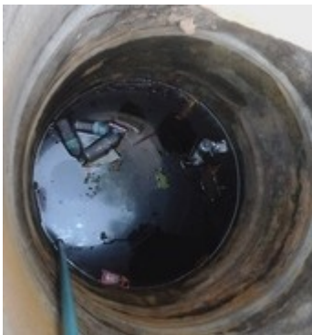
Open waterput met allerlei afval
